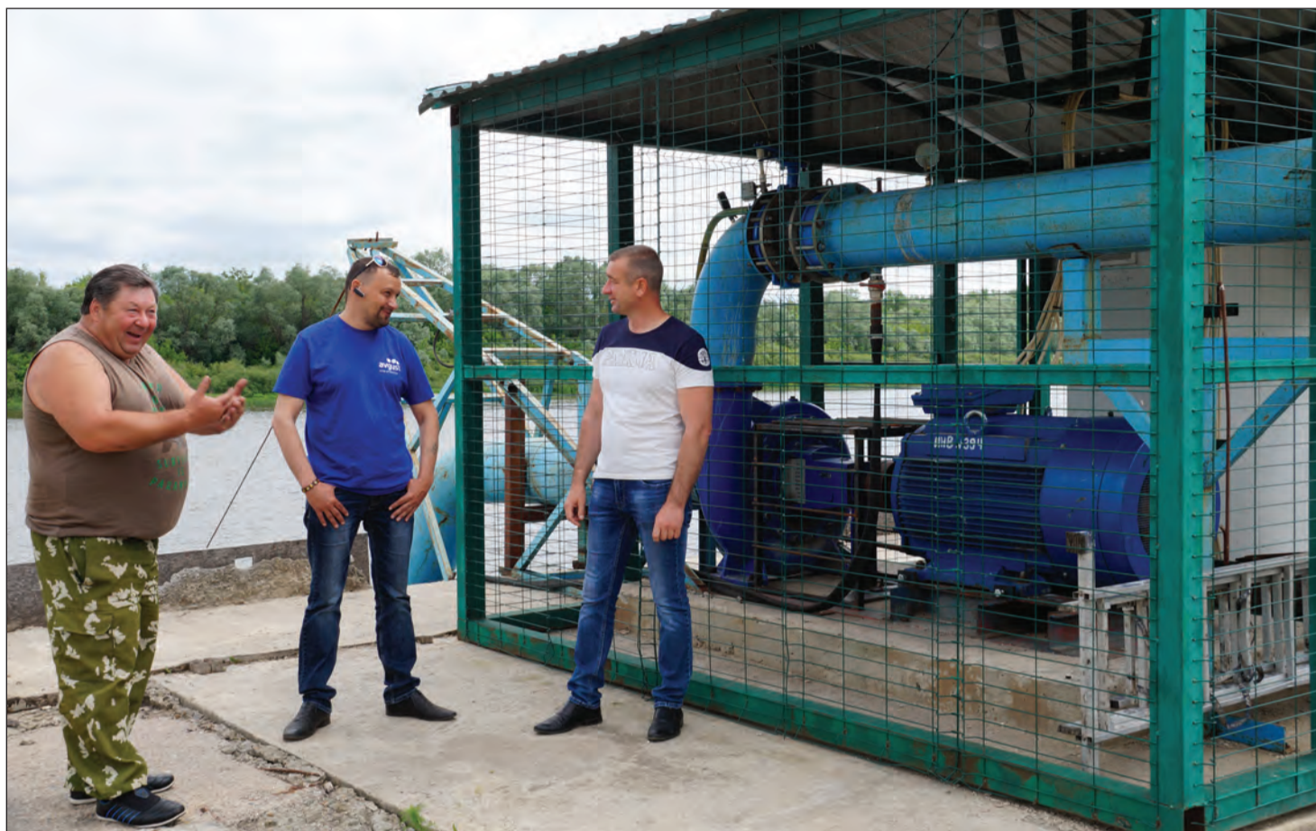
Слева направо: мелиоратор Валерий Горлов, главный агроном Александр Юдин и главный инженер Сергей Рыбанцев – возле насосной станции
