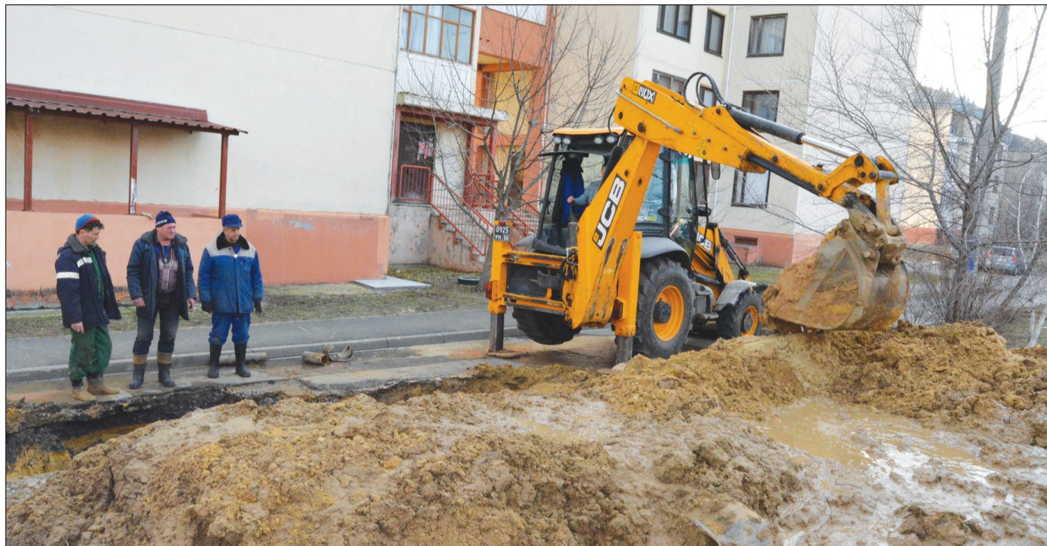
Этой весной водопровод в военном городке порвался в нескольких местах
