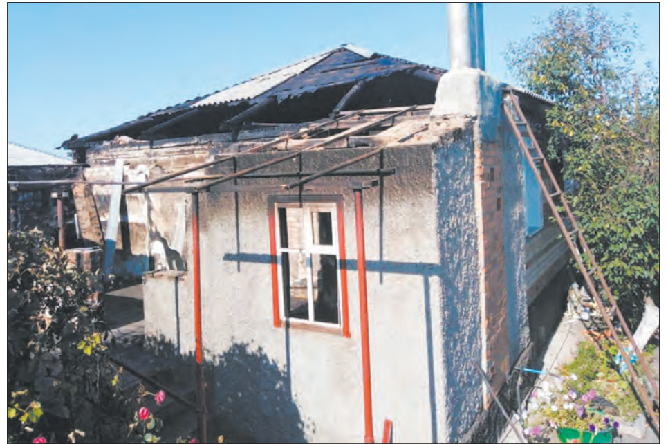
Дом Чередниковых после пожара
